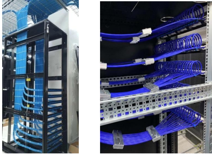
图 3 综合布线系统机柜内理线工艺
